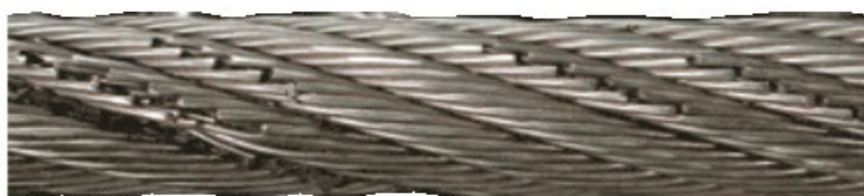
Rys. 6. Zerwane druty w dwu splotkach, występujące w krążku wyrównawczym, spowodowane unieruchomieniem krążka – uzasadnienie natychmiastowej wymiany.
